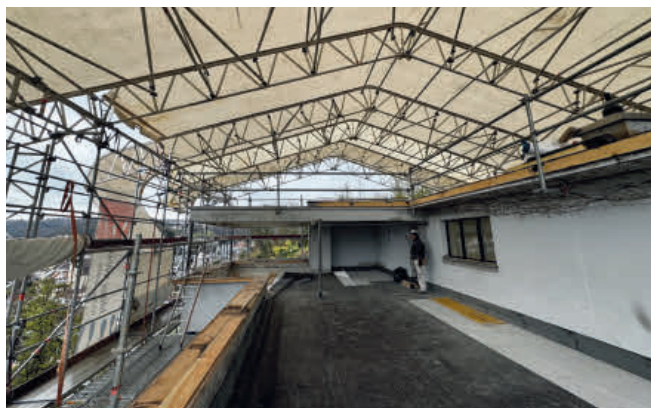
Das Haus musste überdacht werden, damit die neue Decke betoniert werden konnte.
