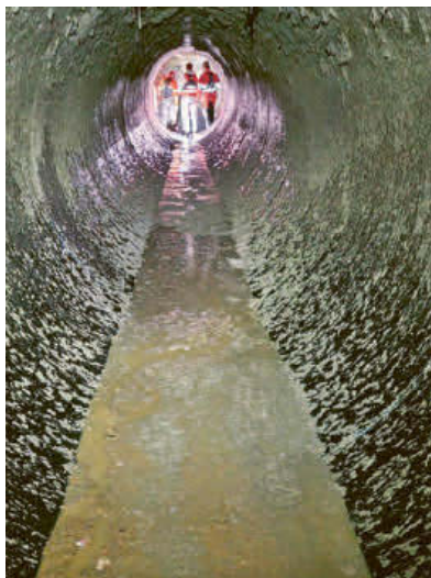
Abwasserrohr unter dem Rhein mit 245 m Länge und 2,2 m Durchmesser
